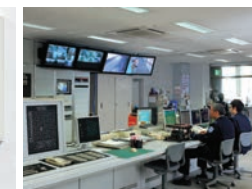
防災センター
