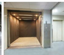
荷物用・非常用EV
