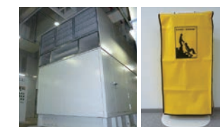
非常用発電機
