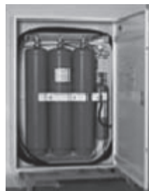
パッケージ型消火設備
