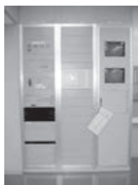
主催者事務室操作盤 (照明等)
