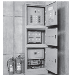
作業用分電盤
