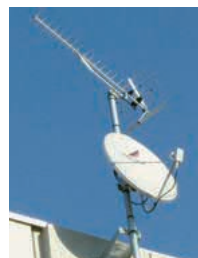
東展示棟に設置した地上デジタル放送の受信アンテナ。地上デジタル放送以外にも、BSやCS110°も視聴できます
